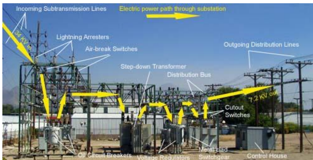
Hình : Trạm biến áp
